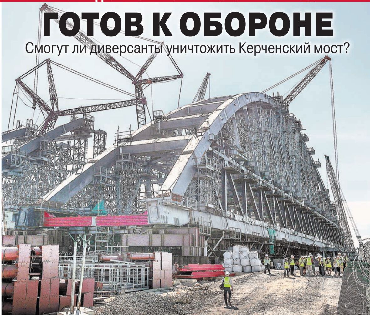
Полсотни иностранных журналистов на днях посетили строительную площадку моста через Керченский пролив. Общее впечатление выразил журналист немецкой газеты «Фрайтаг» Ульрих Хайден: «В моём представлении это было что-то хрупкое, а это, оказывается, такое массивное, такое большое, что-то вечное. Нет слов! Ощущение, что это будет не 100, а 1000 лет стоять».
