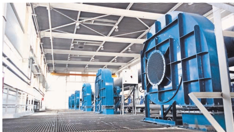
Газовая котельная в городе Троицке (Челябинская обл.).
