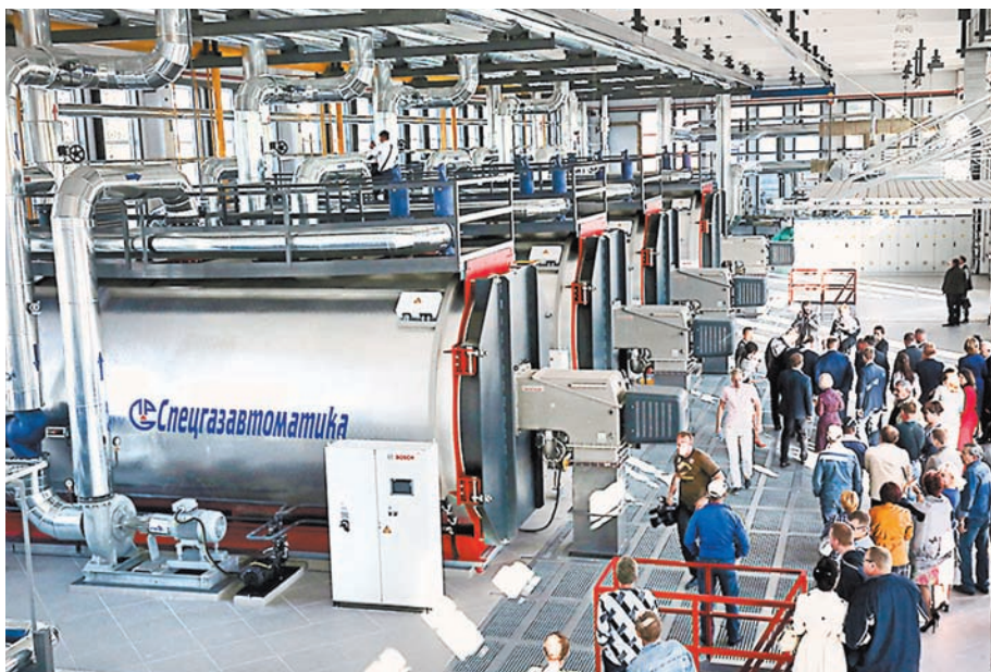
Котельная в городе Советске (Калининградская обл.).
