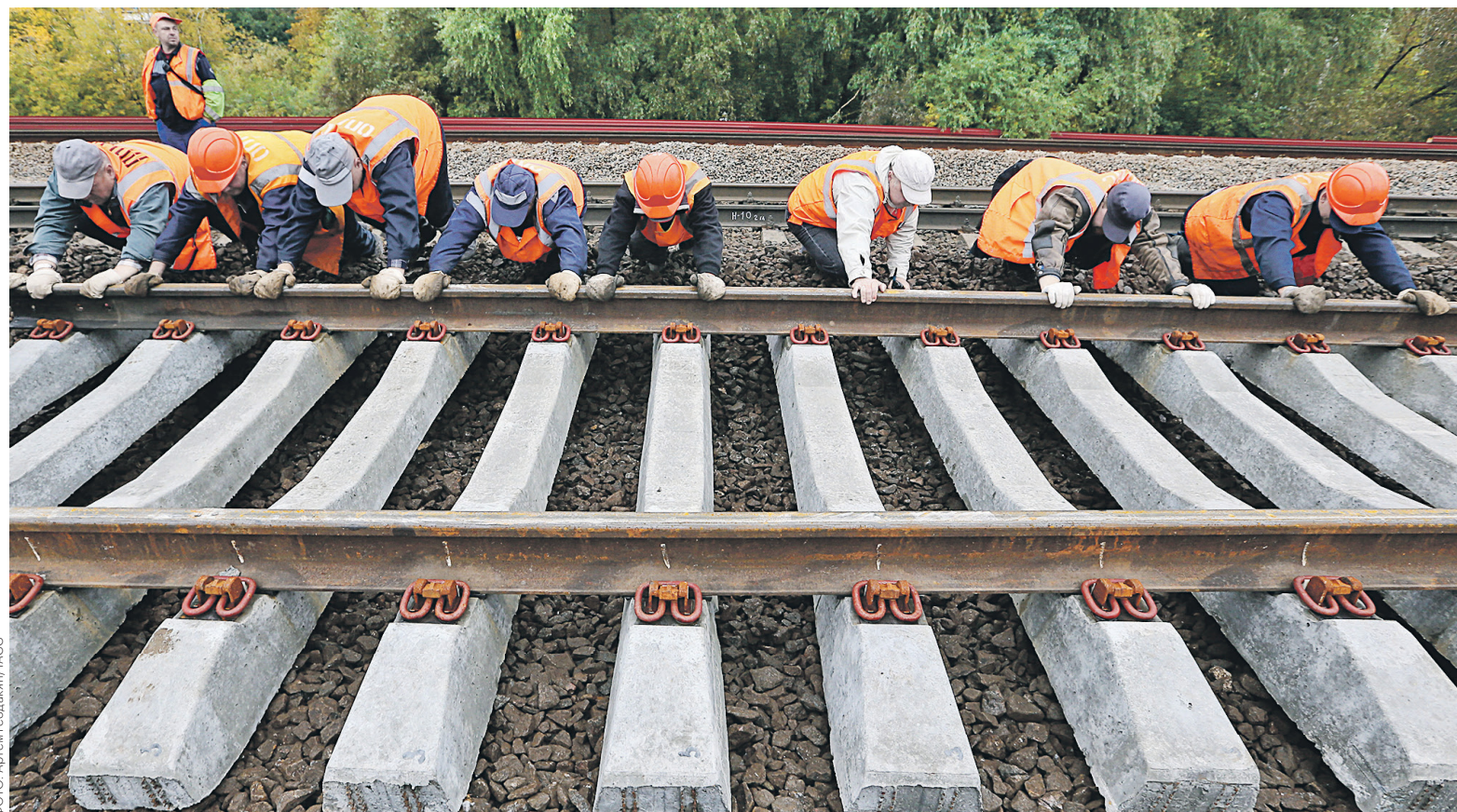
Правительство Сирии предложило РЖД принять участие в восстановлении железнодорожной линии длиной 290 км, соединяющей побережье с месторождениями фосфатов — это один из важнейших проектов страны в области транспорта
