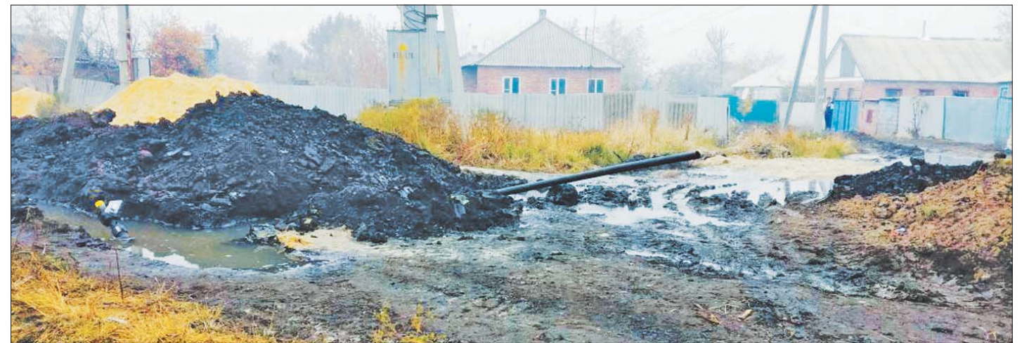
Улица Иркутская «разрыта», ремонт труб не закончен. В траншее провалилась женщина с ребёнком. Фото предоставлено читателями.
