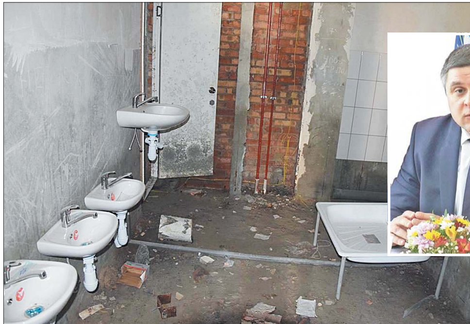
Многоэтажный детский сад в посёлке ХБК начали строить при Денисе Станиславове, но до сих пор здание находится в плачевном состоянии.
