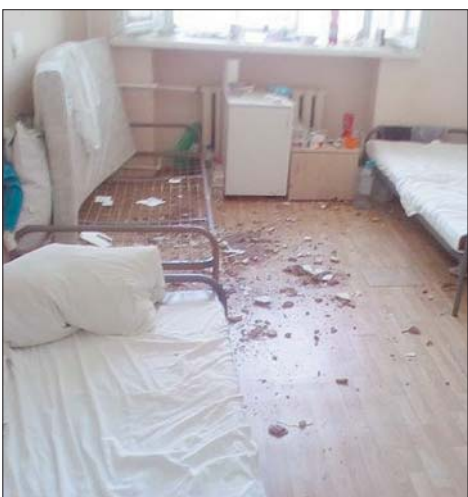
К счастью, в момент обрушения на койке никого не было.
