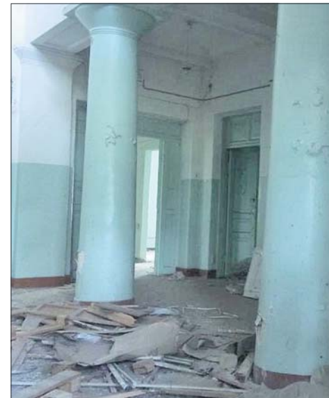
Терапевтическое отделение в аварийном состоянии.
