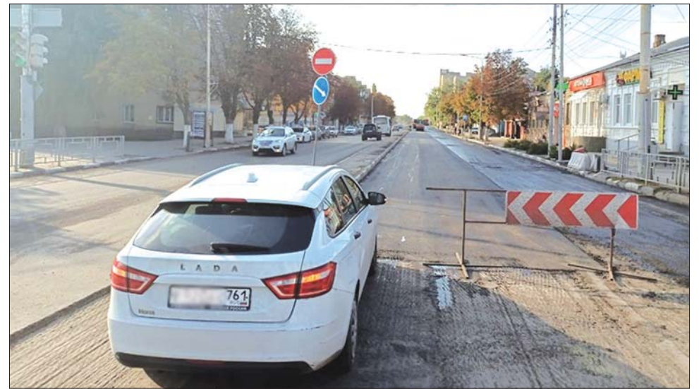
Дорожные рабочие разместили на ремонтируемом участке неправильные знаки.
