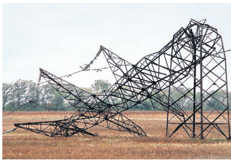
Донбассу не привыкать к перебоям энергоснабжения: ЛЭП в регионе с 2014 года неоднократно страдали от артобстрелов и подрывов ФОТО АЛЕКСАНДРА ЧИЖЕНКА
