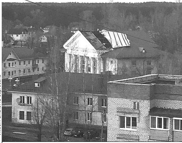
Недавно отремонтированная крыша на доме культуры в Володарском районе сложилась, как бутерброд.
