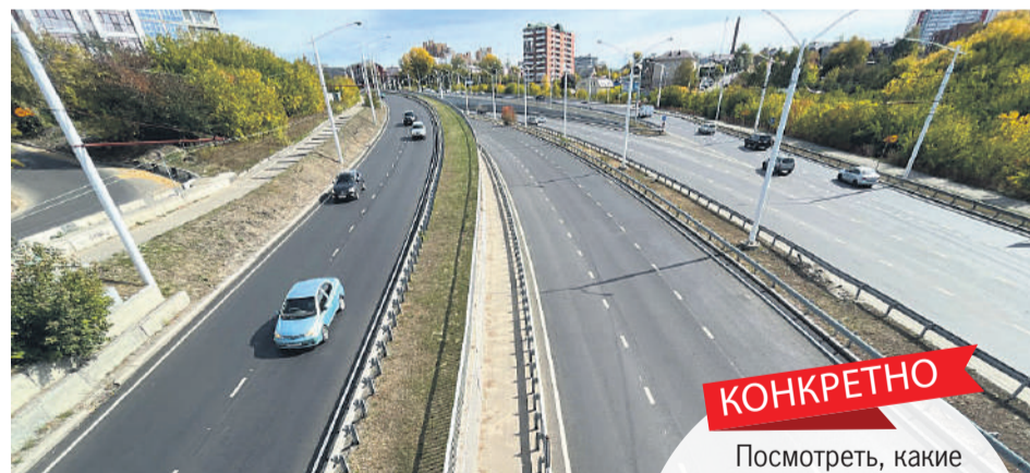
При комплексном ремонте обновляют не только дорожное полотно, но и тротуары, освещение, озеленение и элементы безопасности.
