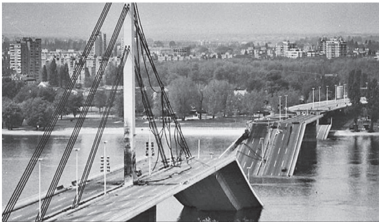
Мост Свободы в сербском Нови-Саде, разрушенный бомбежками НАТО в 1999 году. Сербь стояли на нем толпой, надеясь, что это уберезет мост от авиаударов...
