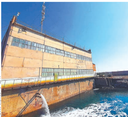
Пропускная способность гидротехнического сооружения напрямую связана с режимами работы ВТЭЦ-2.
