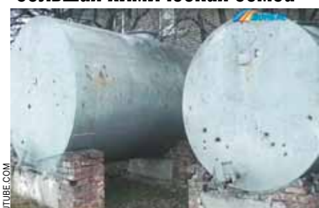
Осколки снарядов повредили резервуары с хлором.
