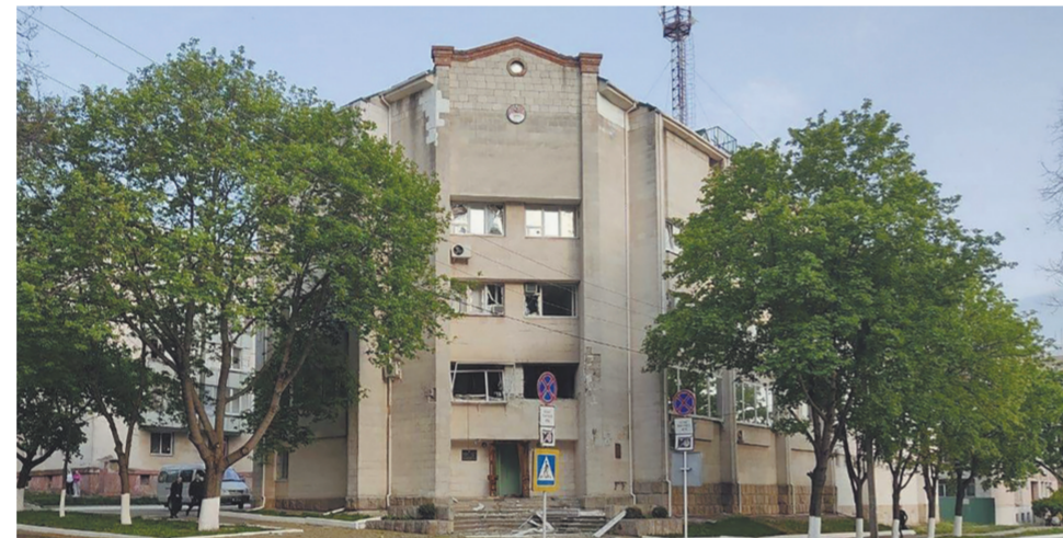
Здание МГБ в Тирасполе, поврежденное обстрелом из РПГ.
