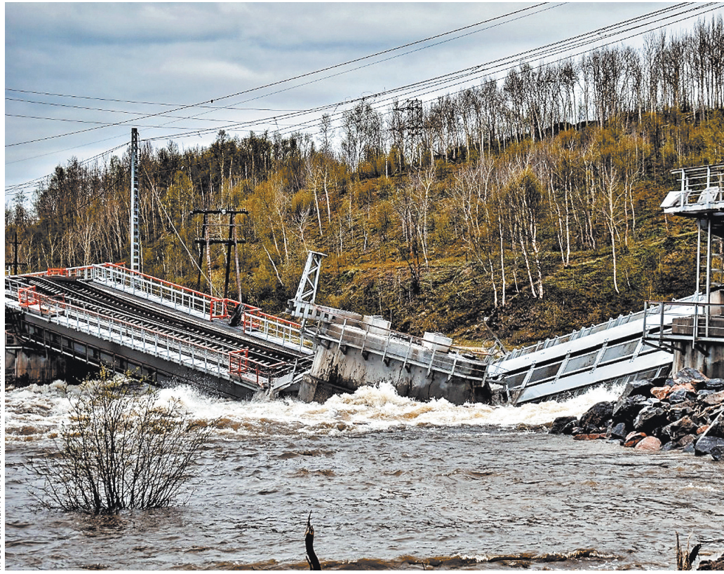
Мост через Колу 1 июня обрушился из-за подмывания опоры.
