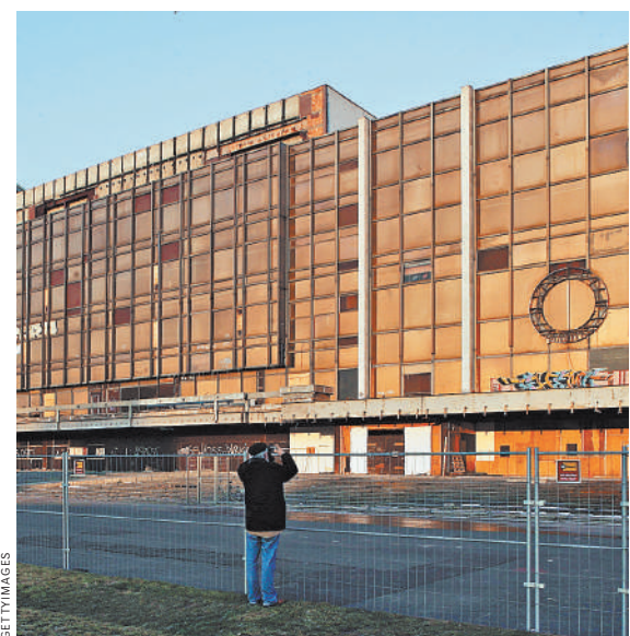
При сносе Дворца съездов вывезли почти 20 тысяч тонн стали, 500 тонн стекла и 56 тысяч тонн бетона.
