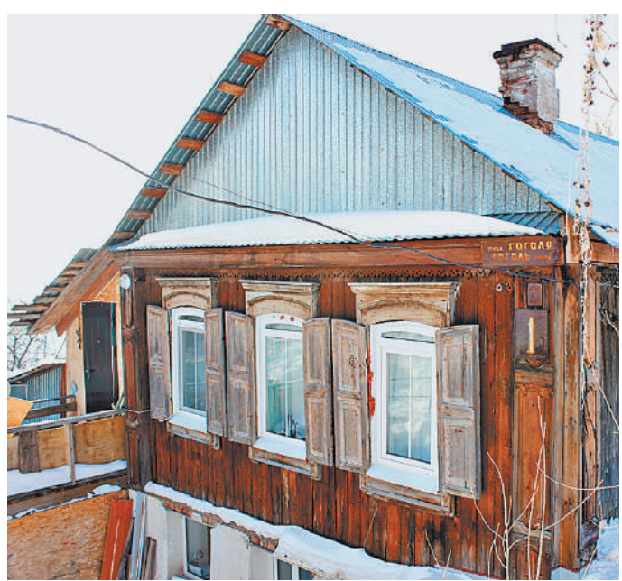
Статус объекта культурного наследия означает, что ничего в доме менять нельзя. Но людям хочется комфортных условий.
