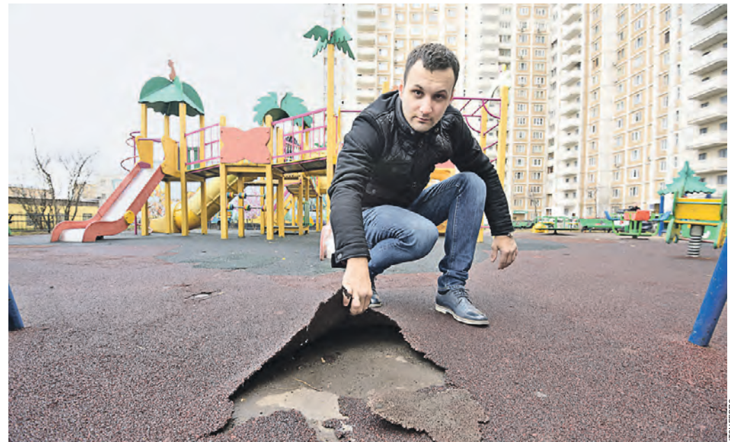
14 апреля 13:52 Никита Янковой проверяет покрытие на детской площадке у дома № 8, корп. 2, на улице Академика Королева. Здесь в ближайшее время подрядчик исправит все поломки, убежден депутат
