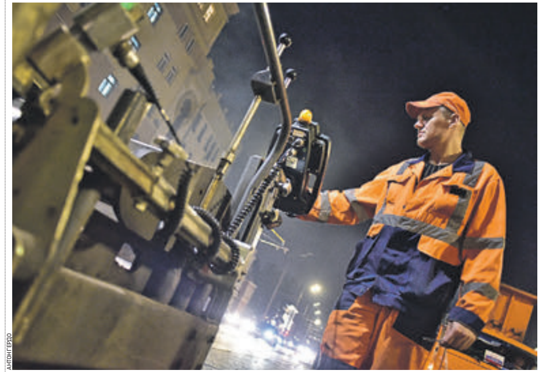
21 августа 23:30 Сотрудник ГБУ «Автомобильные дороги» Александр Гайдук регулирует работу асфальтоукладчика на Садовом кольце
