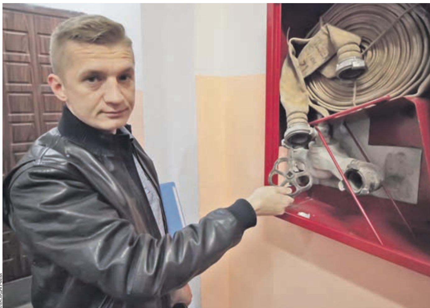
14 июля 11:00 Член Совета дома № 40/42 по Космодамианской набережной Святослав Первов показывает, что пожарные шланги не подходят к крану, установленному в его подъезде
