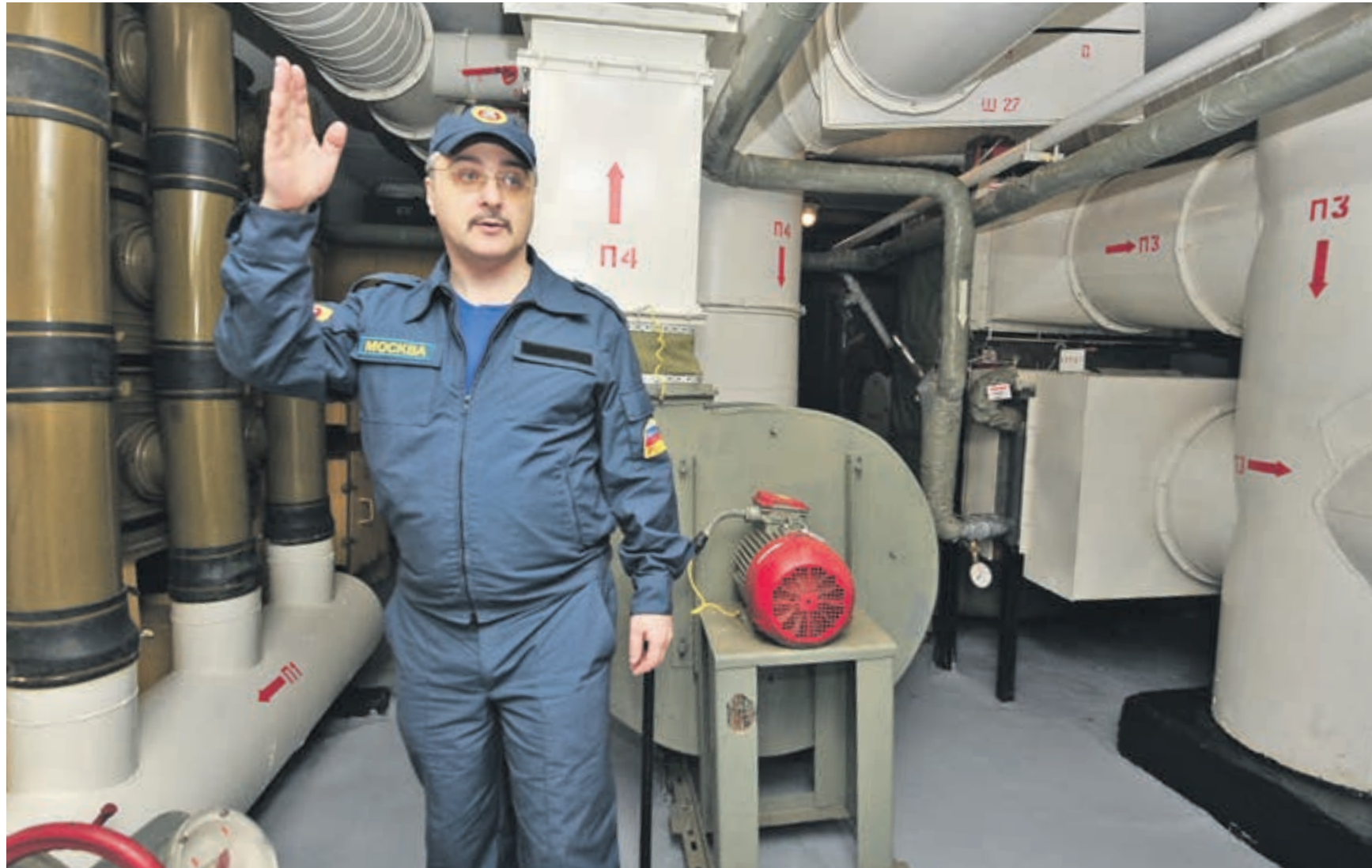
Вчера 11:25 Главный специалист Департамента по делам гражданской обороны, чрезвычайным ситуациям и пожарной безопасности столицы Вадим Шепелев объясняет принцип работы мощной системы воздухообмена убежища ГО на Алтуфьевском шоссе
