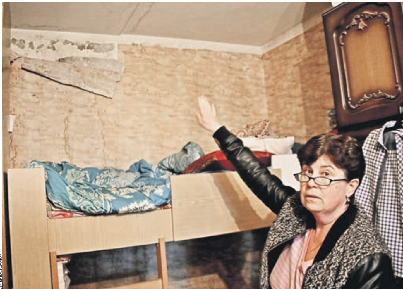
22 августа 12:25 Росошанская, дом 1, корпус 2. Жительница последнего этажа Мария Вирабян, пострадавшая от затопления, показывает корреспонденту «ВМ» последствия капитального ремонта кровли своего дома
