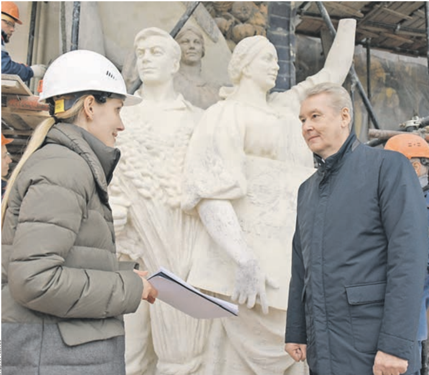
29 сентября 14:21 Советник главы столичного Департамента культурного наследия, куратор реставрационных работ на ВДНХ Юлия Логинова рассказала мэру Москвы Сергею Собянину, как идет реконструкция павильона № 58 «Земледелие»
