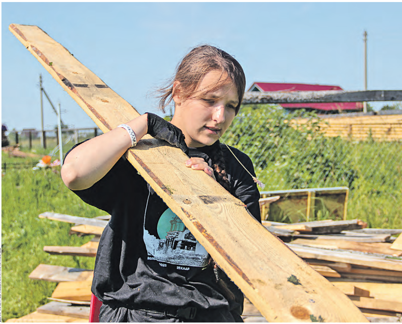
4 августа. Студентка колледжа архитектуры, дизайна и реинжиниринга № 26 Мария Ерискина во время проведения строительно-реставрационных работ в Свято-Никольском храме в деревне Волосово
