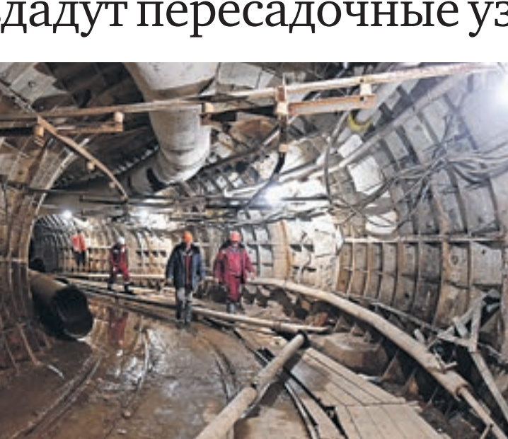
5 марта 2016 года 14:07 Строительство перегонных и станционных тоннелей на новом участке Дмитровско-Люблинской линии завершено. Строители осматривают результат выполненных работ
